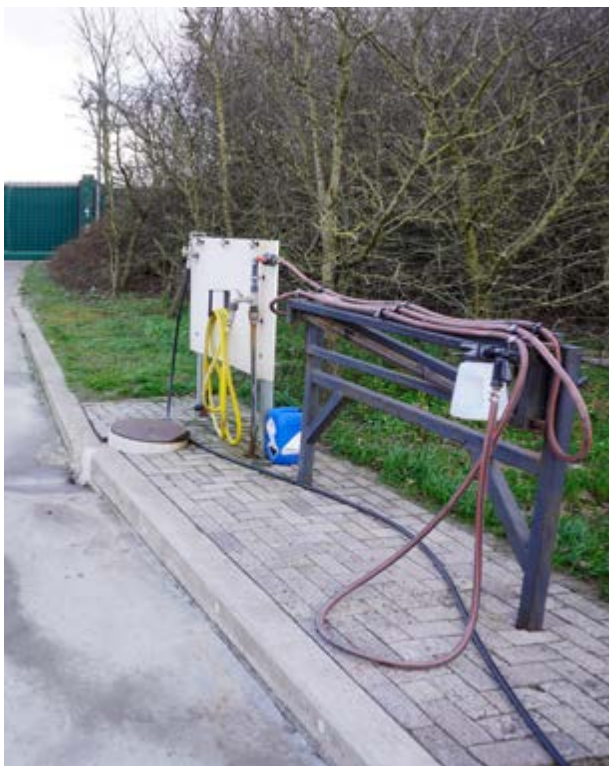
Abb. 99: Fahrzeugreinigung und -desinfektion auf dem Vorplatz.
