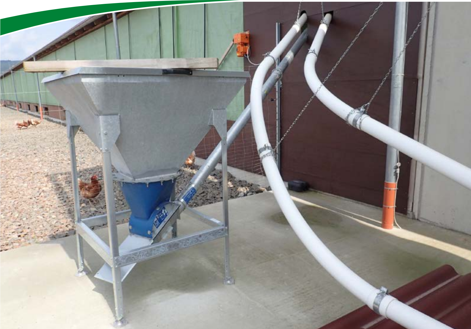
Abb. 49: Zudosierer außerhalb des Stalls.
