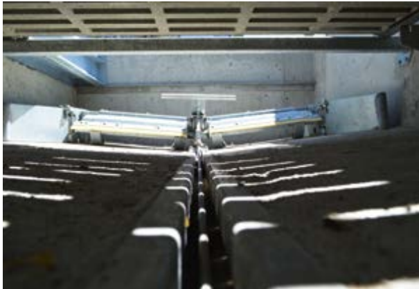
Unterflurschieber im Auslauf eines Mastschweinestalles
