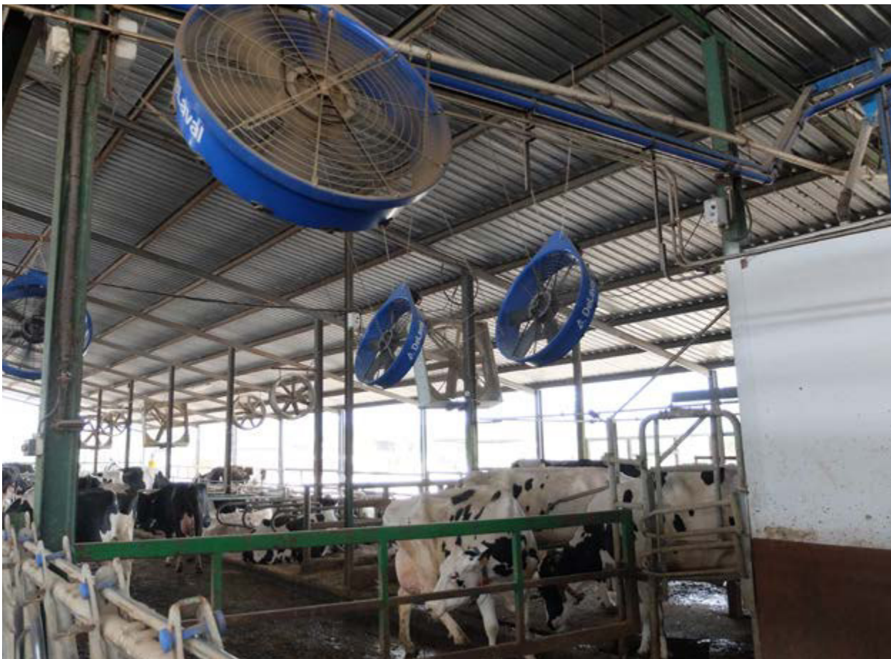
Ventilatoren müssen am Bedarf ausgerichtet werden.
