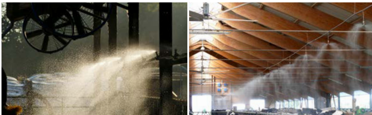
Niederdruckanlage/Sprinkler (links) und Hochdruck-/Verneblungsanlage (rechts).
