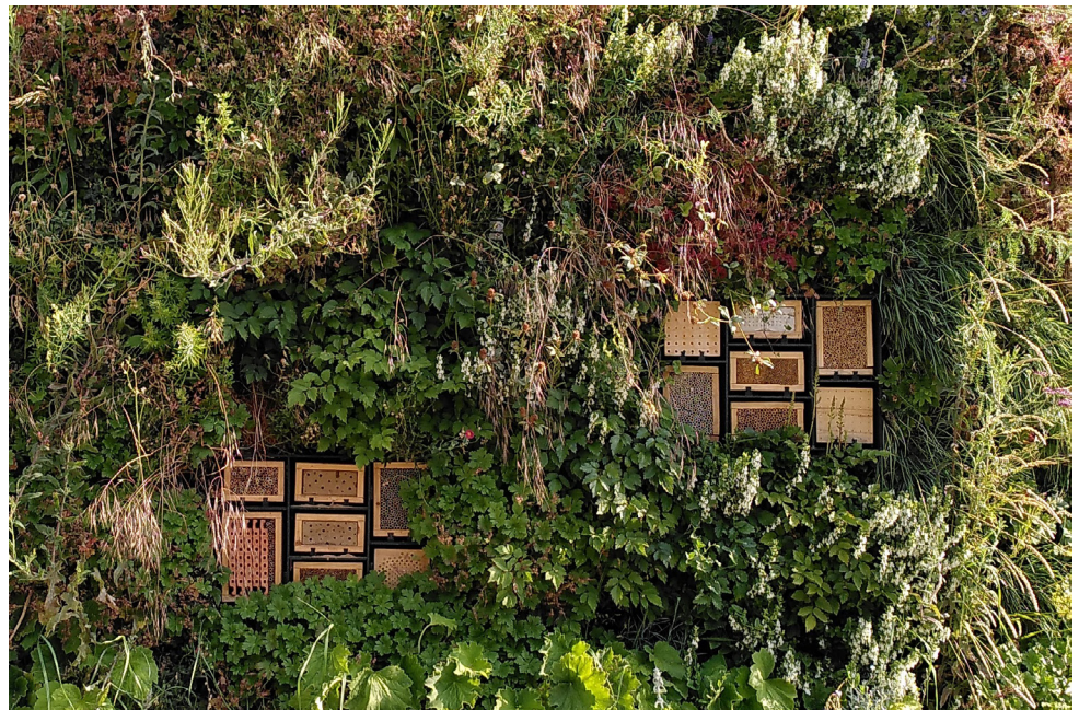
Abbildung 2: Vertikale Modellbegrünung im Projekt BiodivFassade. © Universität Stuttgart – Institut für Akustik und Bauphysik (IABP, Pia Krause)
