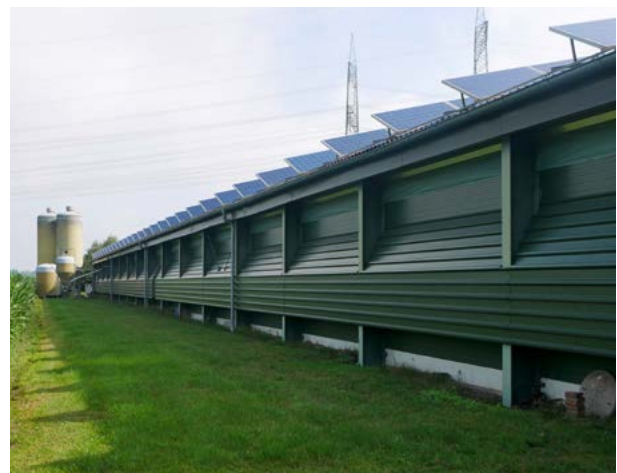
Photovoltaik-Anlage auf einem Stall.
