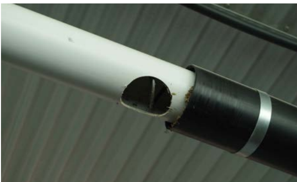
Rohrsystem mit Spiralförderung, über das zeitweise Beschäftigungsmaterial in den Scharbereich gelangt.
