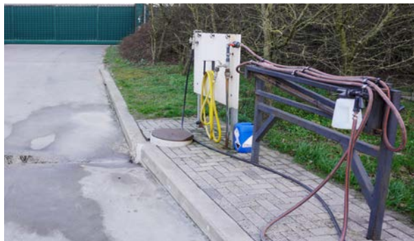
Reifendesinfektion für Fahrzeuge, die in den Innenhof fahren.
