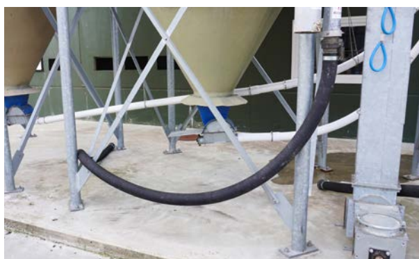
Eigene Siloschläuche sorgen für Sauberkeit an / unter den Silos.
