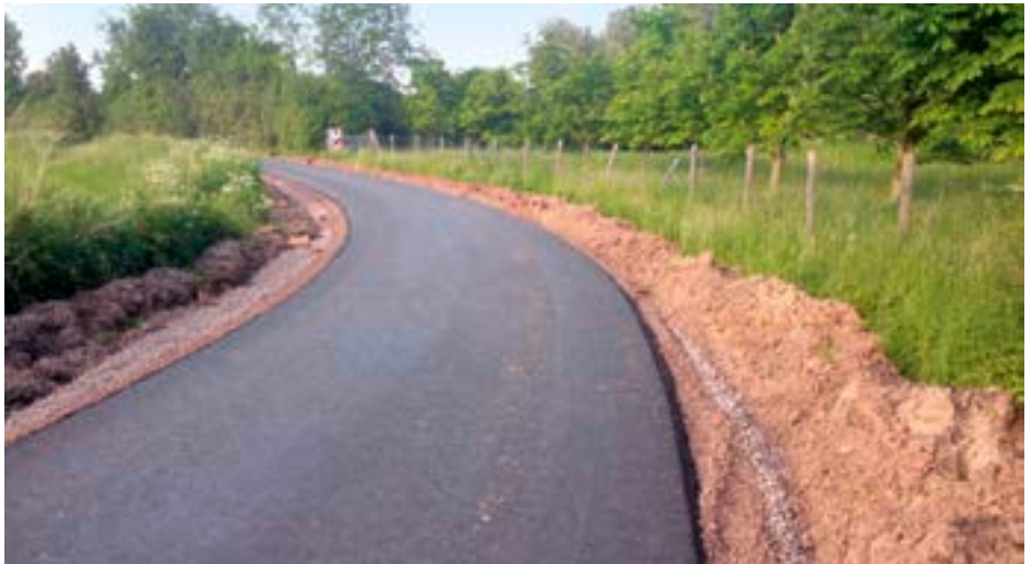
Der Bau ländlicher Wege erfolgt nach der Richtlinie für die Anlage und Dimensionierung ländlicher Wege.
